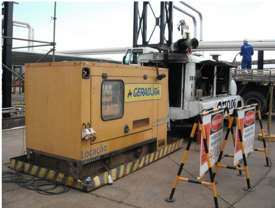
05 – Gerador com bacia de contenção.
